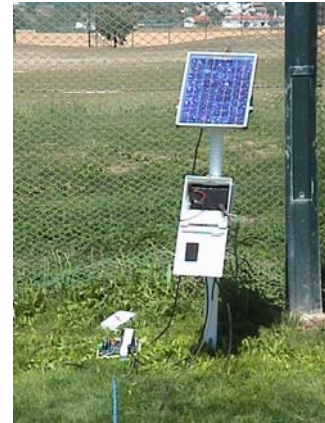
Figura 5 – Painel solar e a ligação do “logger”
