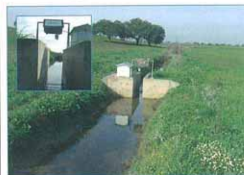
Figura 4 – Estrutura de medição dos caudais escoados por drenagem.
